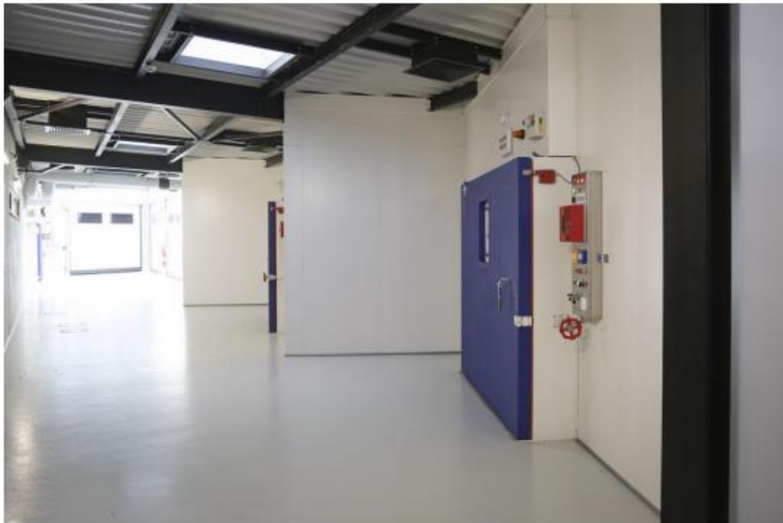
Le nouveau pôle batteries du Critt M2A s'étend sur 1 000 mètres carrés. Crédit : Pascal Guittet
